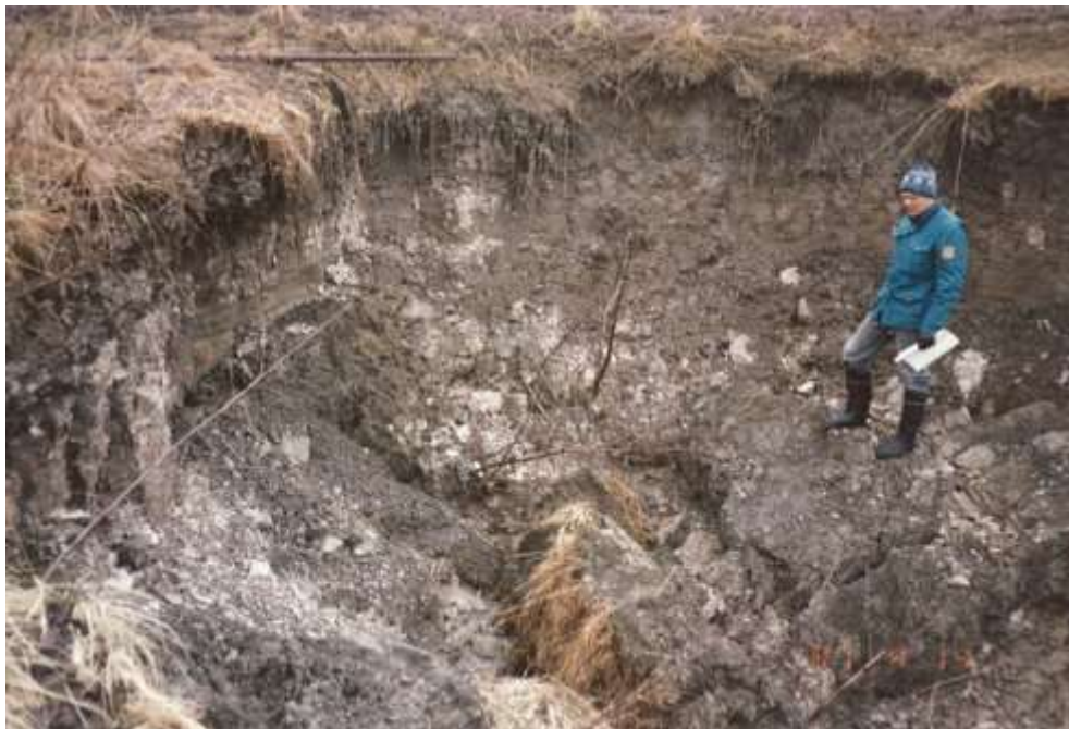
Kuva 8. Maapadon taustalle noin 50 metrin päähän padosta muodostui noin kolme metriä syvä vajoama vuonna 1987.
